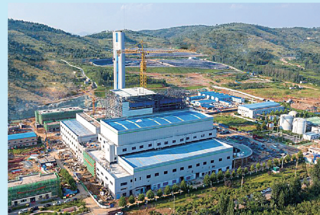
资源再生利用典范——中科垃圾焚烧热电联产项目
