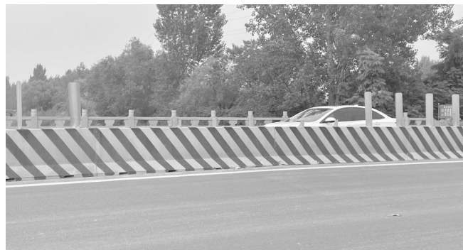
8月2日,在318省道薛城区常庄镇路段,道路中间的防眩板损坏。(记者 单成镇 摄)
