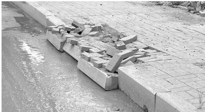
8月9日,在薛城区榴园大道的人行道上,地砖和路沿石松动破损。(记者 杨舒 摄)
