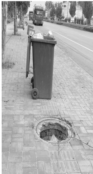
8日,在薛城区店韩路上,一窨井盖缺失。(记者 杨舒 摄)
