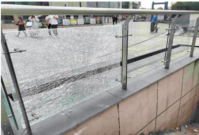
近日,在中区中央广场内,多块护栏玻璃出现破损。(记者 孔浩 摄)
