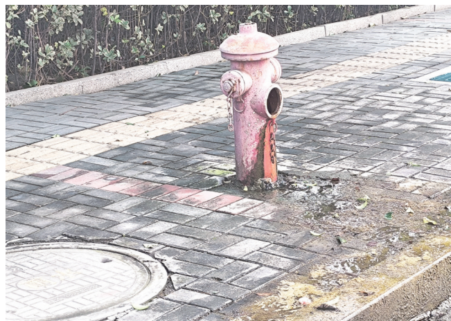
10月15日,高新区松江路与燕山北路交会路口附近,一消防栓长期漏水,周围地面上长出了青苔。(记者 董艳 摄)
