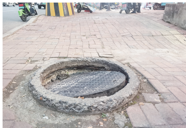
10月14日,在中区龙头中路的人行道上,一窨井盖破损、松动。(记者 王萍 摄)
